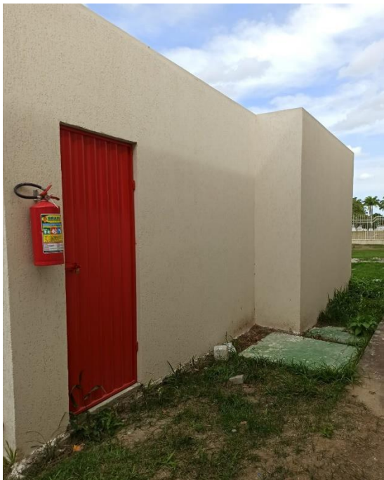
Foto 3 – Casa de bomba PU
