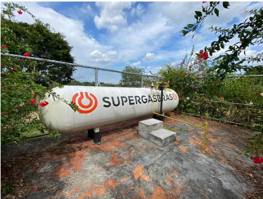
Foto 5 – Central de gás
